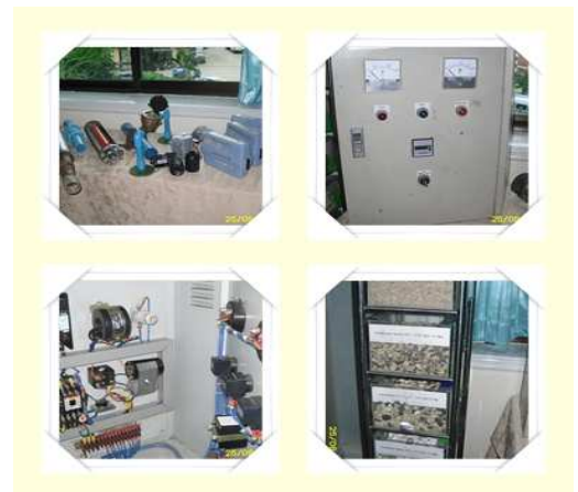
อุปกรณ์ เครื่องมือ ของระบบประปา
